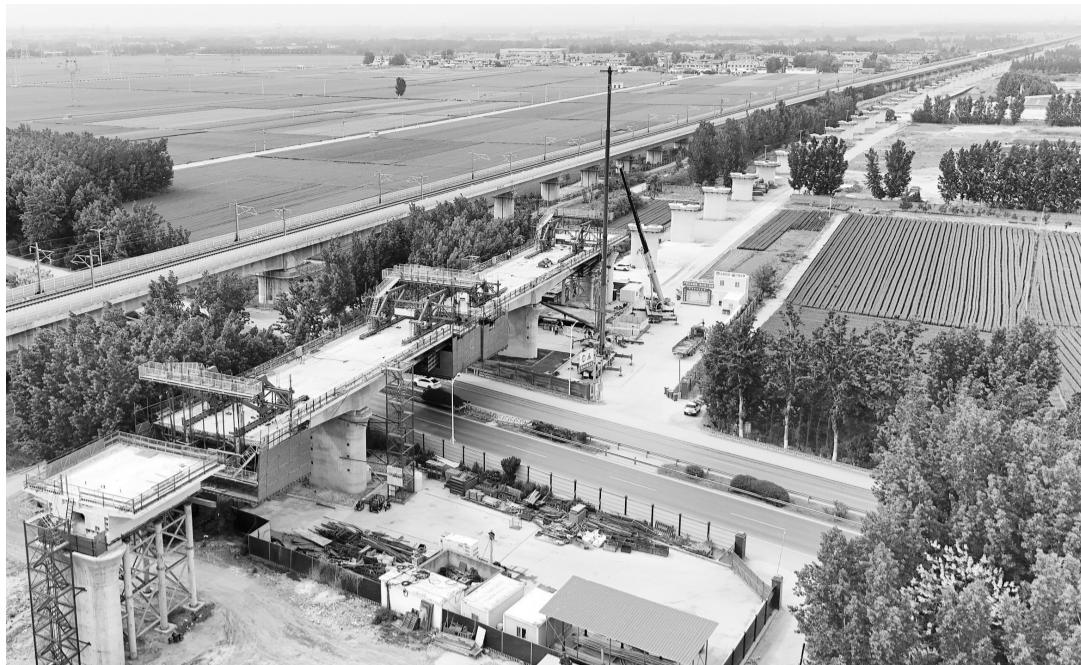
“五一”期间,济枣高铁建设工地上建设者抢抓“黄金季”,有序推进项目建设。图为济枣高铁跨兖石铁路特大桥连续梁施工现场。(济宁晚报全媒体记者 王仰浩)
