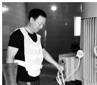
工作人员在泵站内检查运行状态
