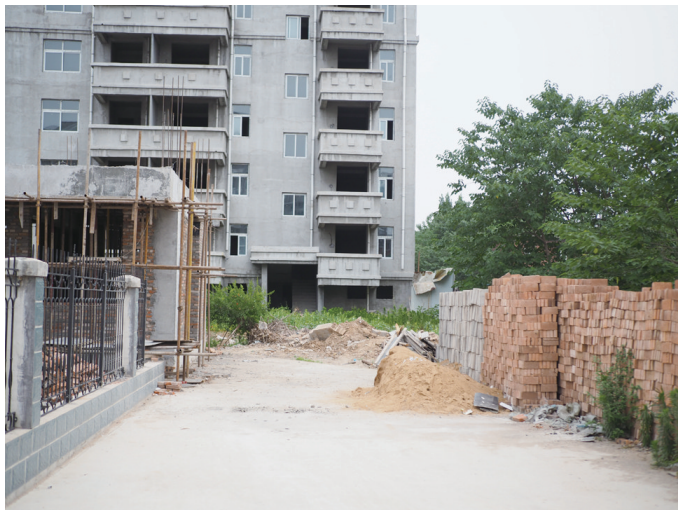
天仙嘉苑小区里,建筑垃圾无覆盖和遮挡物。此外,创城宣传广告牌破损老旧,未及时更换。[20180601号]
