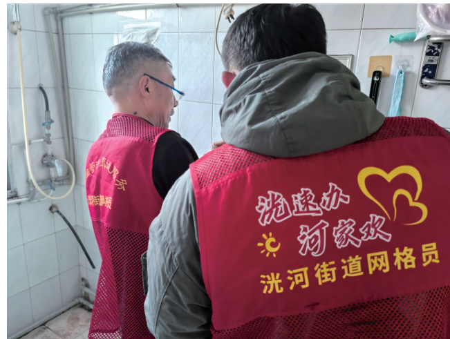
近日,济宁高新区洸河街道东坝社区第四网格的网格员收到居民求助信息:家中水管突然爆裂,造成室内积水。社区迅速组织志愿服务队上门服务,维修水管并恢复用水,解决居民实际困难。 ■通讯员 郭玉青 沈玉波 沈朕 摄
