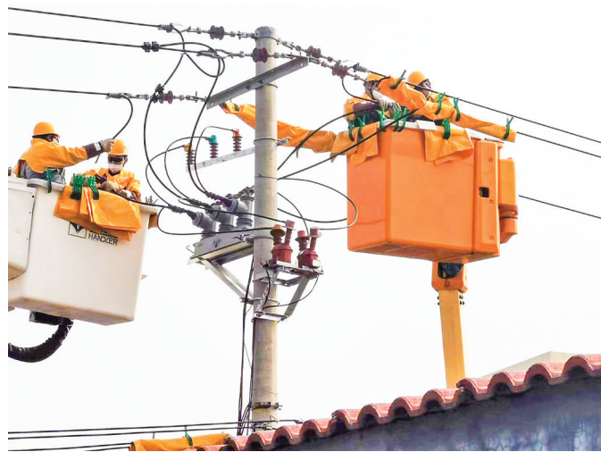
任城区供电公司学习成果转化为推动工作的实践,对客户供电设备进行排查,确保安全稳定运行。
