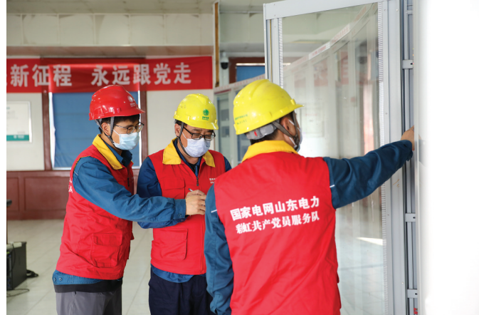
变电运维中心对220千伏罗厂变电站开展设备特巡。
