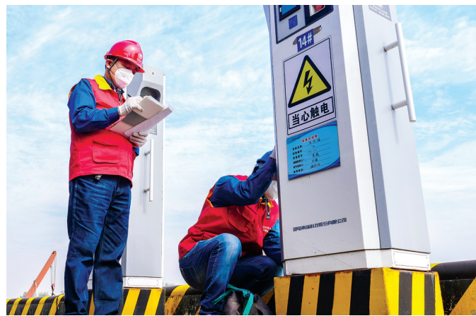
梁山县供电公司彩虹共产党员服务队队员到济宁梁山港问诊把脉用电设备,保障港口安全可靠供电。
