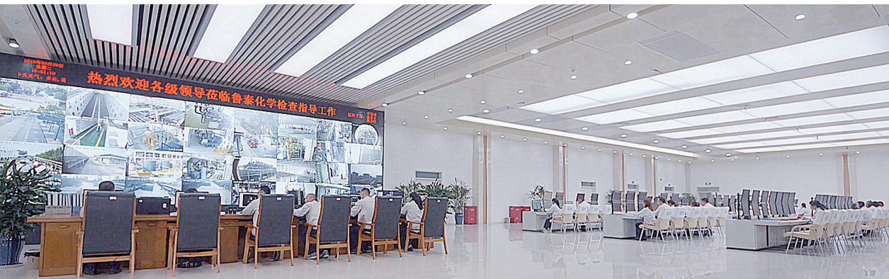
鲁泰化学智能化集中控制中心、调度指挥中心
