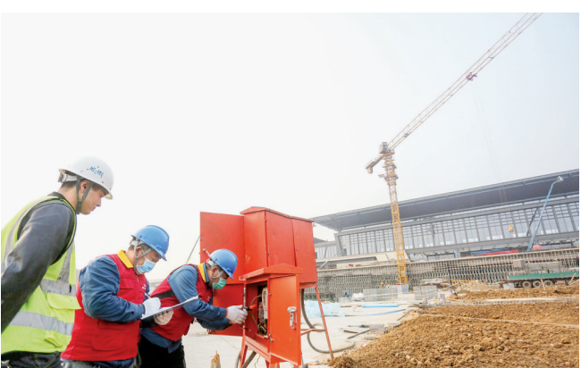
2021年底,济宁高铁北站将建成通车。为进一步优化营商环境,10月21日,国网济宁市任城区供电公司组织人员对济宁高铁北站建设工程进行用电检查,保障工程建设用电安全。
