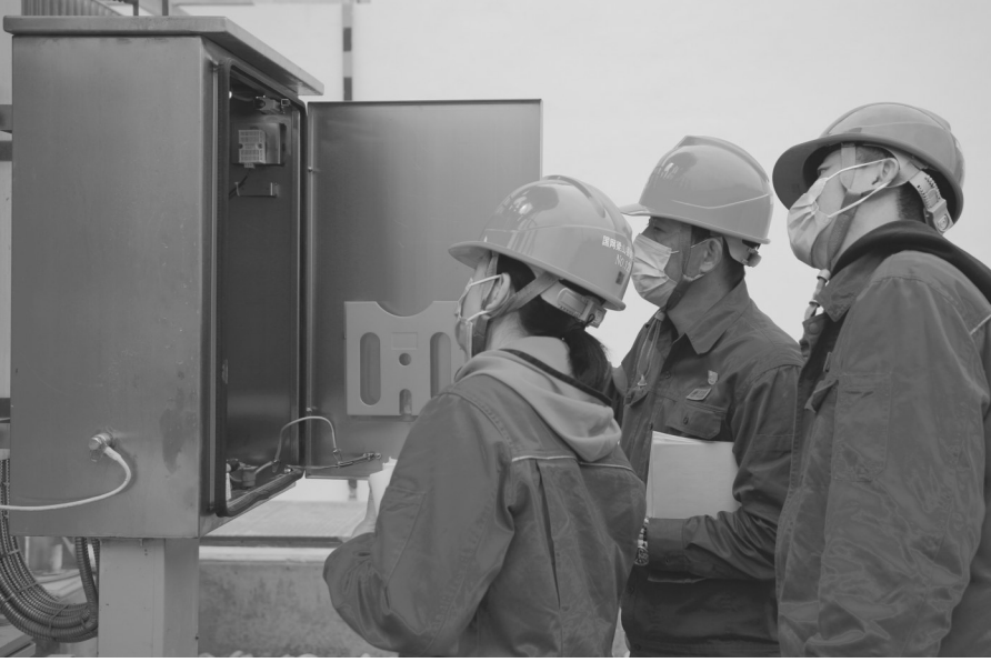
梁山县供电公司青年员工放弃“五一”假期休息时间,对即将投运的35千伏韩岗变电站内的变压器、组合电器、开关设备开展交接验收工作,确保变电站如期投送变电。
