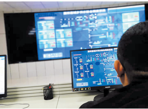
嘉祥县“城乡供水一体化”使全县自来水供水连成一张网,通过远程系统可实现管理统一化、中心化、远程化。图为青山水厂指挥调度中心。
