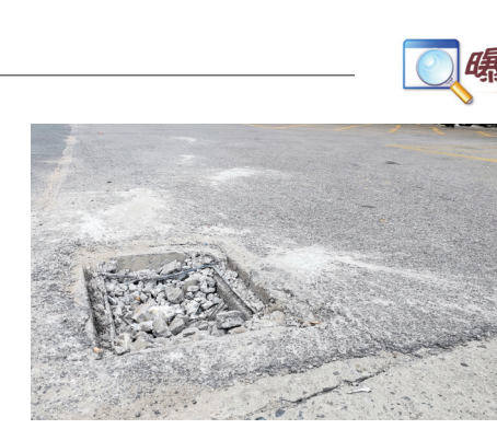
在任城区古槐路东侧晨阳庄园南区门口,一处井盖出现破损,需要有关方面及时修复。 ■记者 陈硕 摄 20200854号
