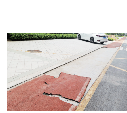
记者在任城区碧桂园·印象小区看到,这里存在路面破损、车辆随意停放和杂物乱堆乱放等现象,亟待整改。 ■记者 陈硕 摄 20200853号
