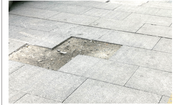
近日，记者在任城区狄园街看到，该条道路上有部分路面出现破损，需要有关部门及时修复。 ■记者 陈硕 摄 20200834号
