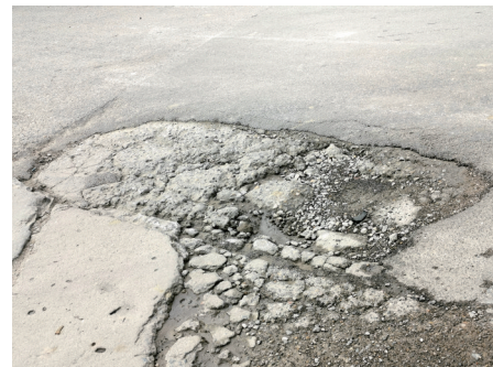
近日，记者在任城区南池路与玄帝庙街十字路口东侧看到，一处路面出现大面积破损，需要有关部门及时修复。 ■记者 陈硕 摄 20200830号
