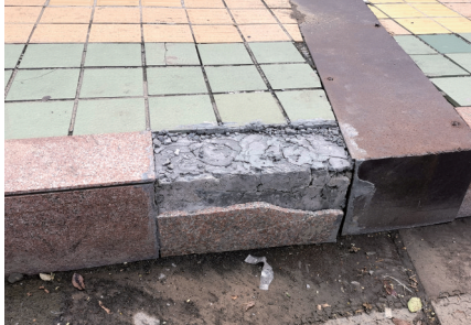
在凯赛大桥东侧,有一处路沿石出现破损,需要有关方面及时更换修补。 ■记者 陈硕 摄 20200790号
