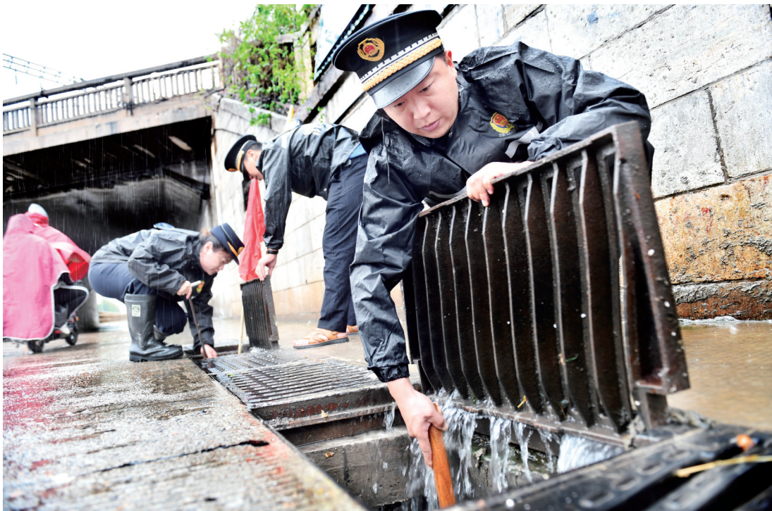
7月22日上午,市城管综合执法支队队员正对辖区内重点位置积水点进行排查。
