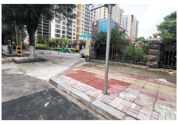
近日，记者对曝光的20200726号问题进行回访时看到，济安桥北路存在的路沿石破损的问题已得到修复。
