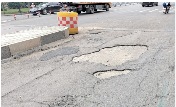
近日,记者在济宁高新区金宇路浣府河桥东侧看到,一处路面出现大面积破损,影响了行人通行,希望有关部门及时修复。 ■记者 陈硕 摄 20200718 号
