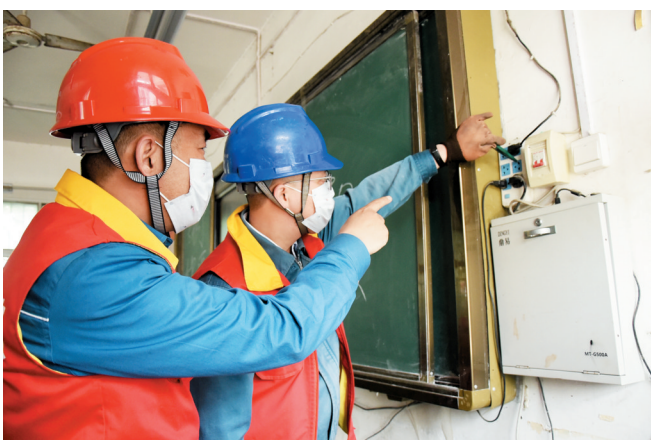
为保证新学期学校各项工作的顺利开展，给广大师生营造一个良好的供用电环境，国网山东鱼台县供电公司唐马供电所党员服务队来到鱼台县实验中学开展安全用电检查，并对配电室内的一级、二级等剩余电流动作保护器进行了试跳，确保各级保护正常工作。
