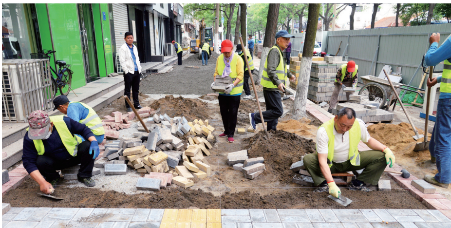
任城区今年计划实施8条主干道整治提升工程,11条街巷道路改造提升工程,通过城市道路及其附属设施通病治理导向,不断强化其承载功能,进一步提升市政设施完好率,为市民创造一个整洁有序、交通顺畅、舒适宜居的城市环境。图为海关路人行道改造提升现场。■记者 刘建新 摄
