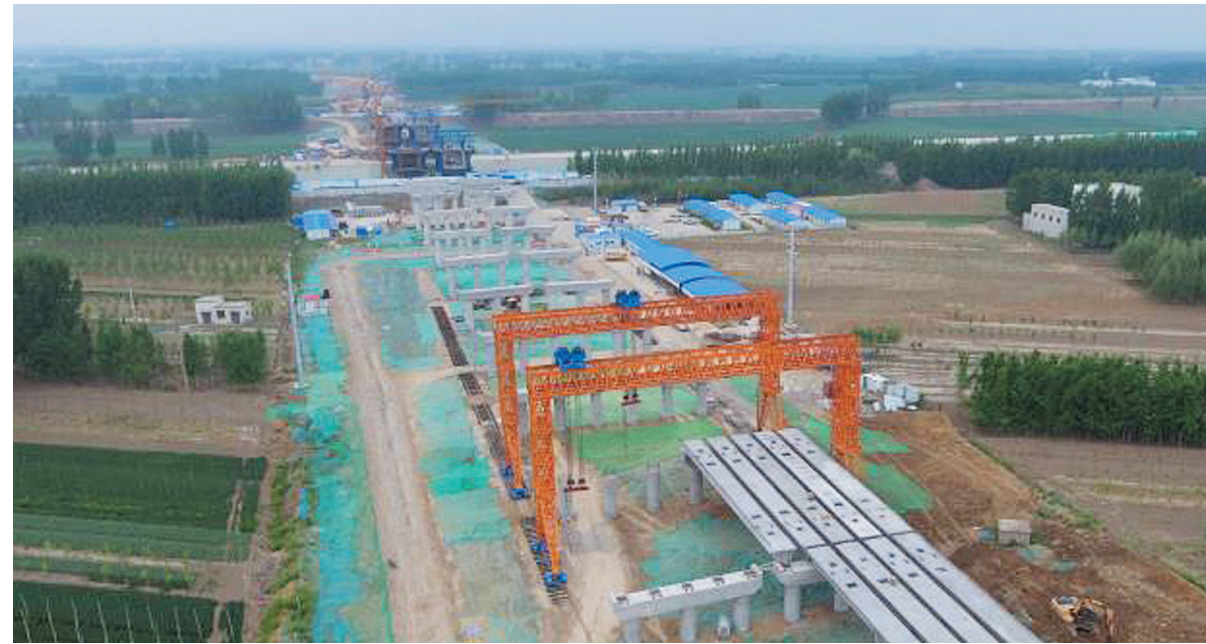
济宁西二环项目起点位于G105汶上任城界，终点至现G105与机场路交叉口处，全长33.4公里。途经城区、经开区，采用一级公路标准，路面宽22-30.5米。目前，全线路基工程完成土石方填筑90%，桥梁工程正在进行箱梁施工。其中，G105西二环省道S319线(原省道S338线)以南路段计划2018年10月底完工通车，省道S319线以北路段计划12月底完工通车。图为西二环京杭运河大桥建设现场。■通讯员 张波 摄
